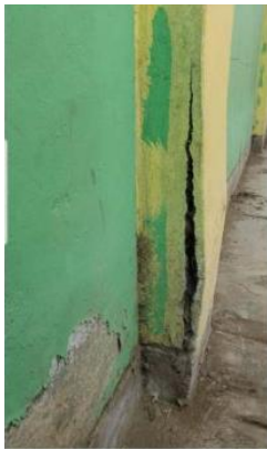
Figura 7: Columnas reventadas por el acero corroído.
