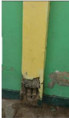
Figura 8: Corrosión del acero en las columnas
