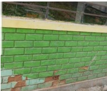
Figura 6: Paredes deterioradas, es un problema muy común casi en todas las paredes de la Institución educativa.
