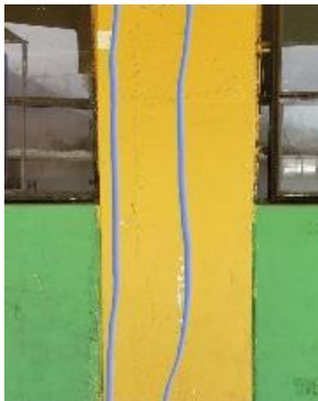
Figura 9: Rajaduras longitudinales en columna principal
