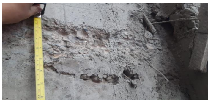
Foto 01. Medición en la zona de patología desprendimiento existente en columna.
