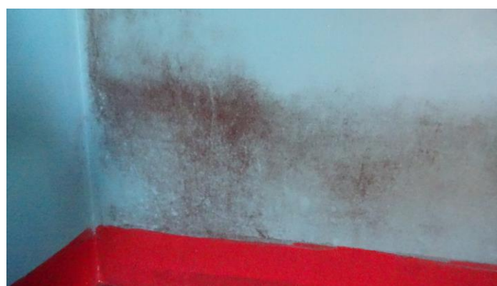
Foto 03. Detectando la parte afectada de la patología de humedad severa
