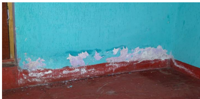
Foto 04. Identificando la zona humedad interior de la residencia desencadenando eflorescencia Fuente: Elaboración del equipo de trabajo
